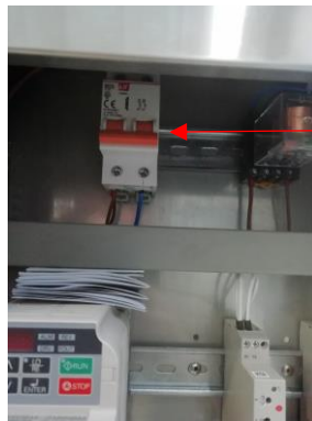
Cuadro unidad generadora hielo
