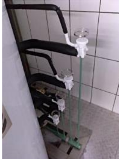
Válvulas expansión generador hielo
