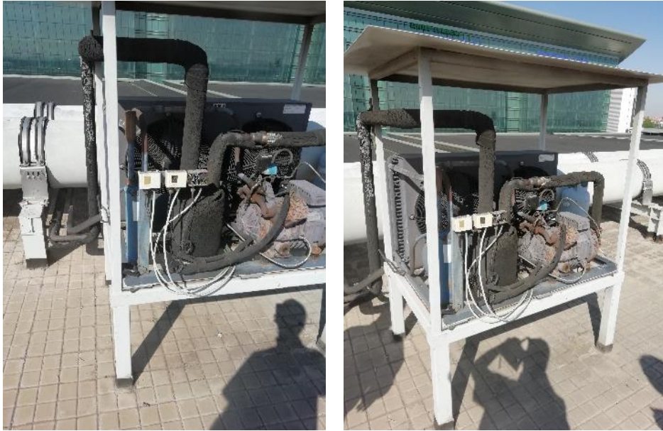
Unidad condensadora actual, a retirar, mantener bancada sin techo para la nueva
