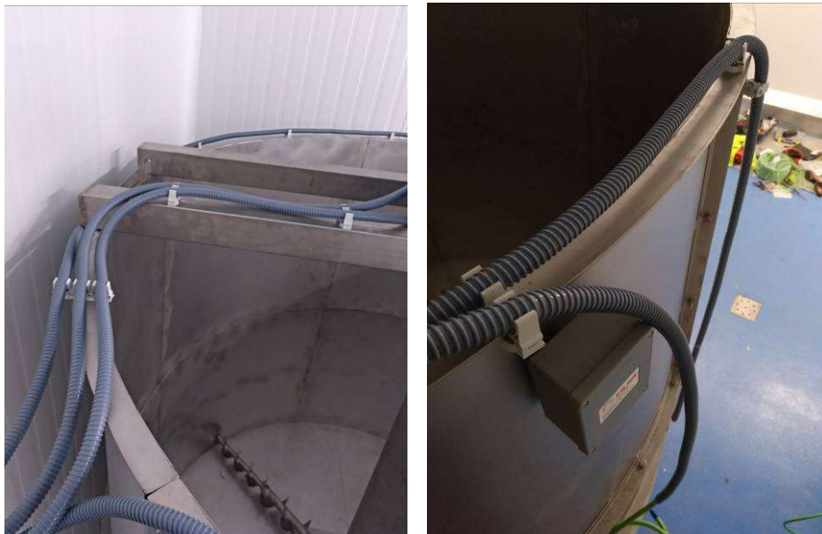
Cableado por parte superior silo
