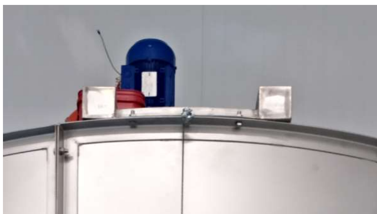
Tornillos pasantes para sujetar bancada motores en la parte alta del silo
