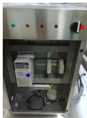
Panneau unité de génération
