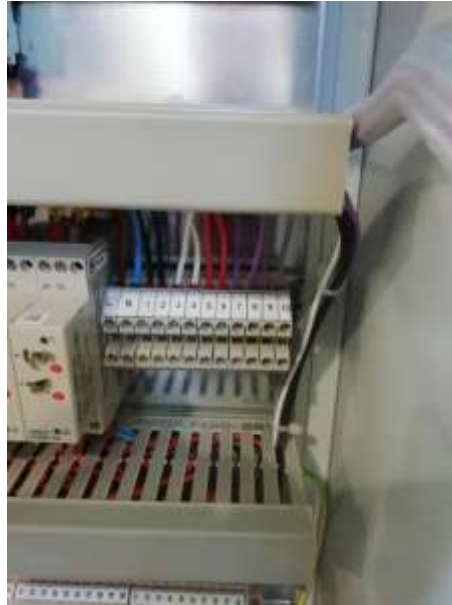
Bornier du condenseur générateur
