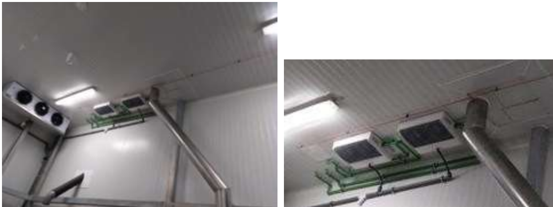
Refroidisseurs de la partie supérieure
