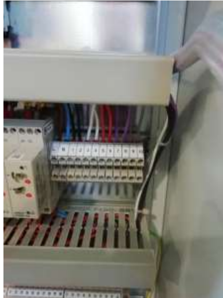
Bornero cuadro unidad condensadora generador
