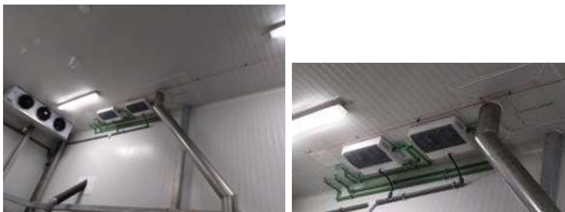
Enfriadores en cubierta
